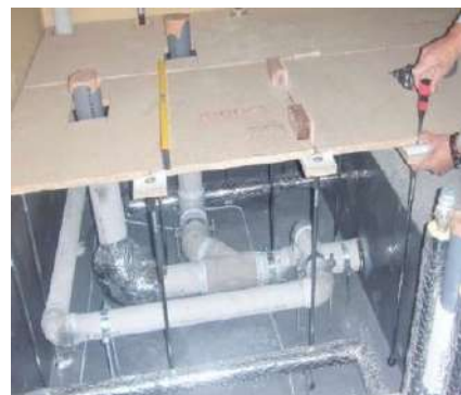
[ 医療センター配管・配線用：ピット部 ]
